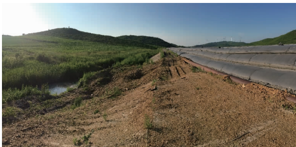
图17 某模袋坝因坝基渗透破坏而滑动变形
