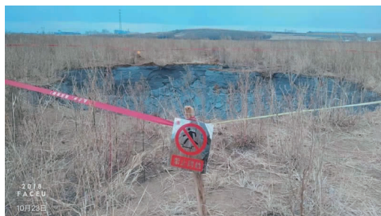
图21 某水灰场排洪管道错位渗漏导致灰面出现天坑
