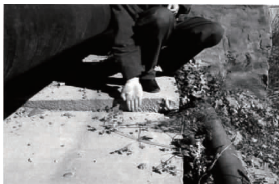
(a) 坝顶混凝土板塌陷
