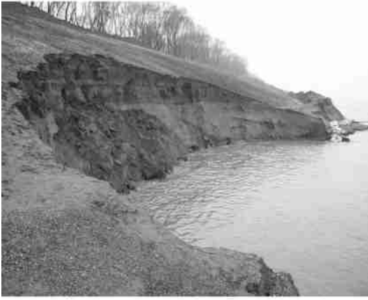
图 12 试验工程整坡施工后出现的巨大窝崩
